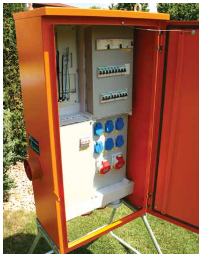
Provedení v souladu s normou ČSN EN 60439-4 ed.2, přehledné a logické uspořádání vnitřních komponentů
